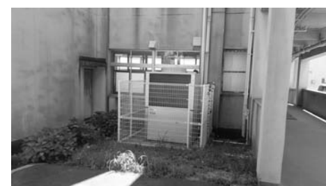
豊明中図書室のエアコンの室外機
