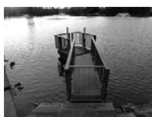
三崎池の水位調整弁の操作装置
