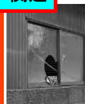
窓が割れた 管理不全空家
