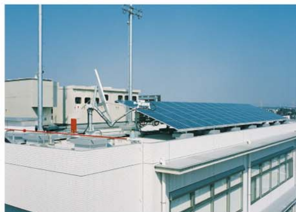
庁舎屋上の太陽光発電システム
