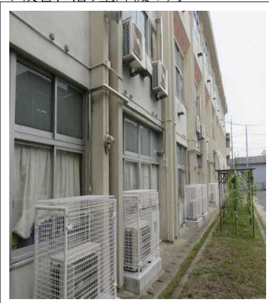
▼校舎に沿う室外機の列
