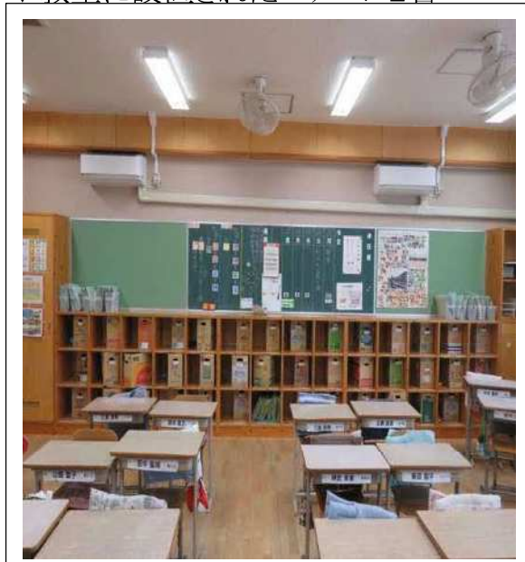
▼教室に設置されたエアコン2台
