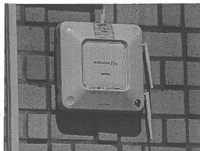
議場内の無線 LAN アンテナ
